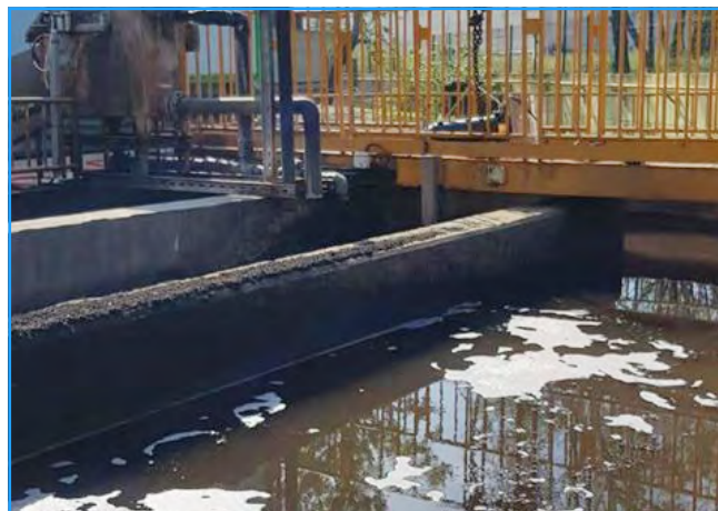
Один из резервуаров очистной установки
