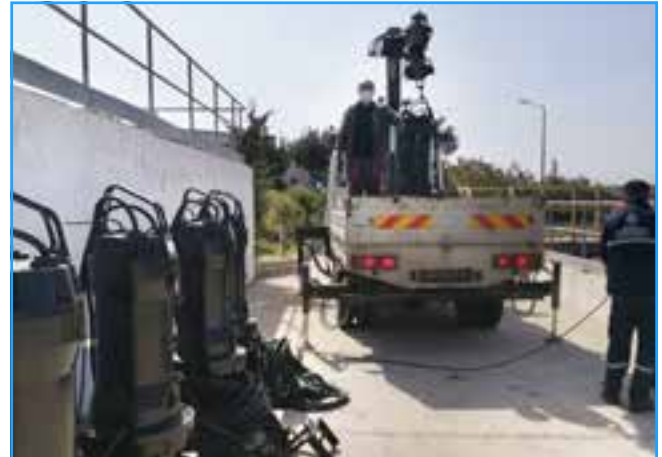
Насосы перед установкой
