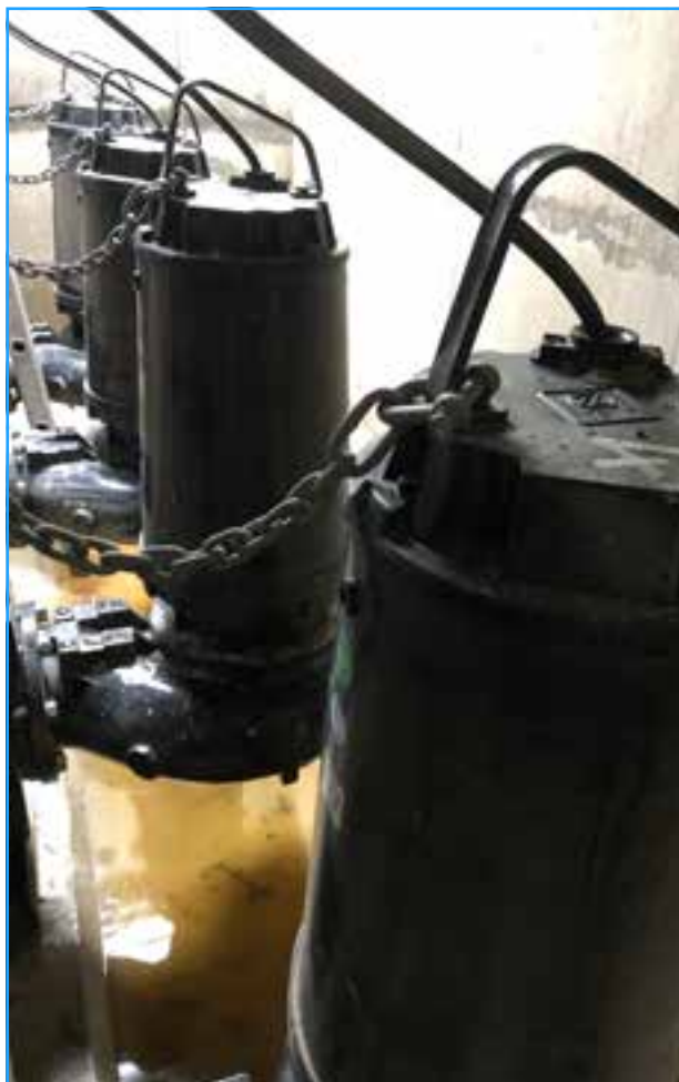
La stazione di pompaggio di Uniqa.
