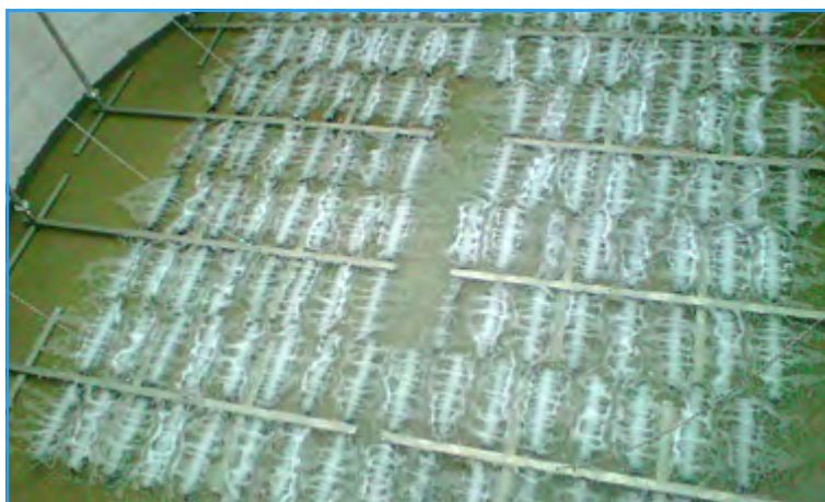
L'impianto in funzione
