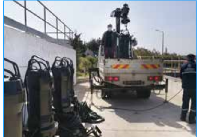
Las bombas antes de la instalación
