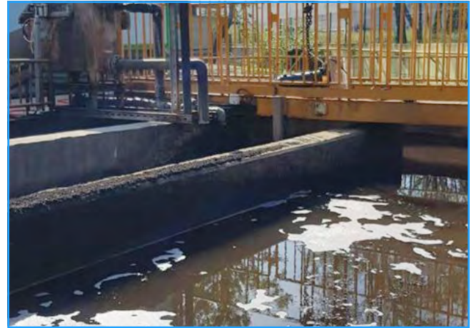
Uno de los tanques de las instalaciones de depuración
