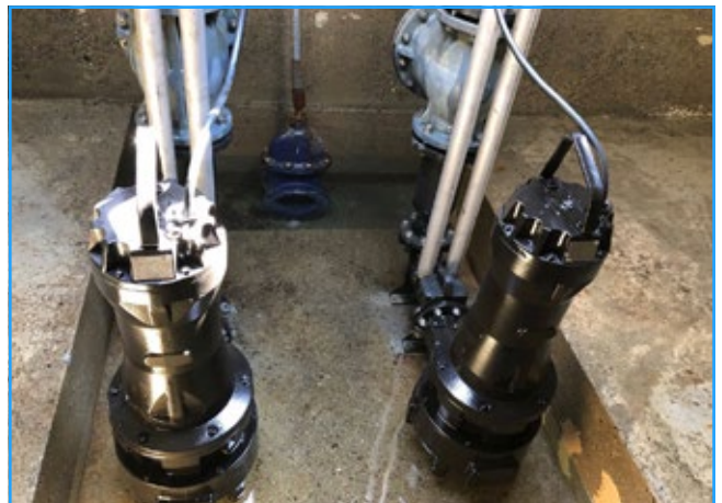
Die Installation von Zenit UNIQA im Sumpf
