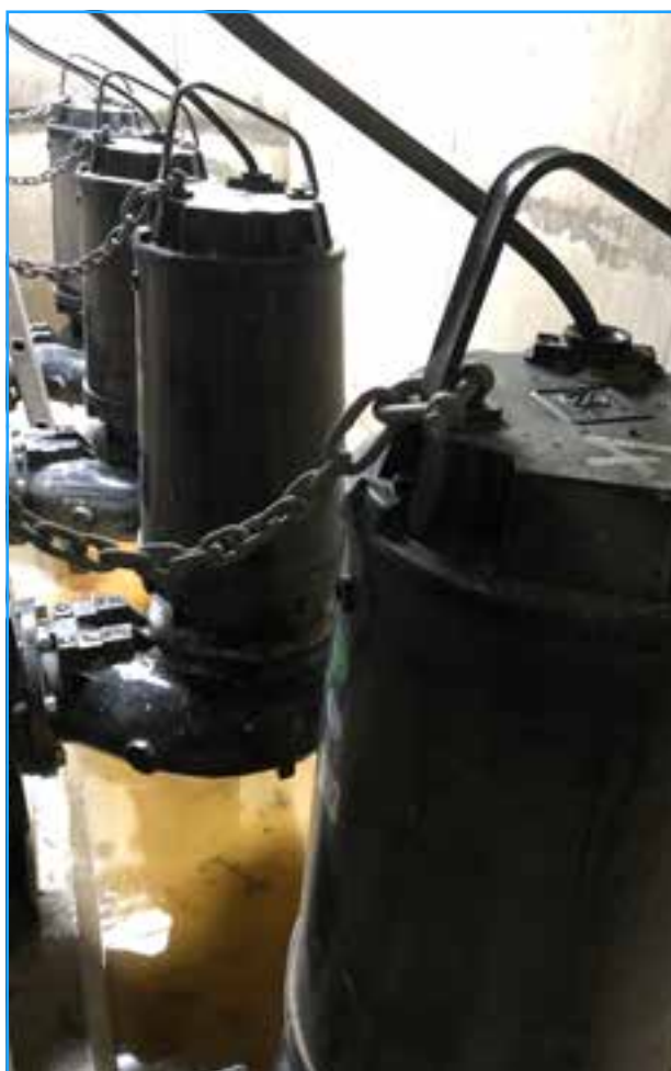
Насосная станция Uniqa.
