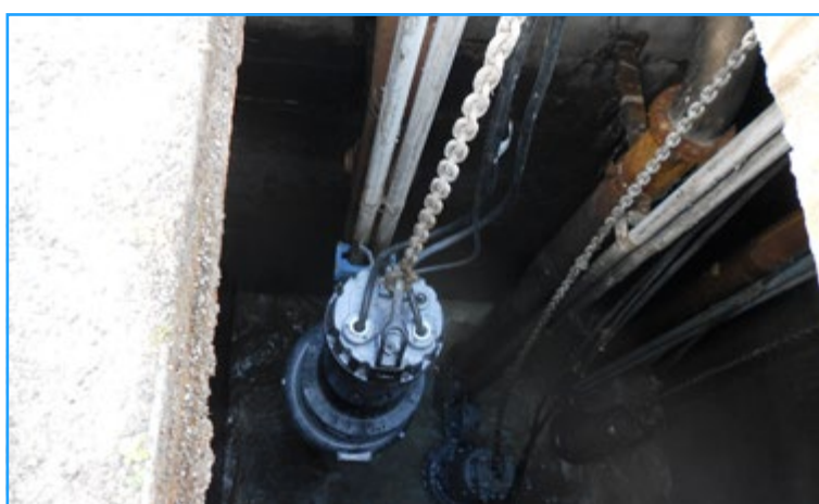
Il pozzetto di rilancio
